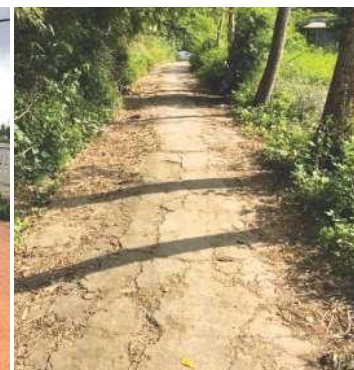
Hình 8: Đường nội thôn xây dựng giai đoạn trước nay đã xuống cấp tại xã Mò Ó, Đakrông, Quảng Trị
