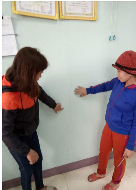
Trụ sở tiếp dân xã Hải Thành vừa bàn giao 6 tháng đã nứt
